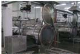
Deo tehnološke linije za proizvodnju dečije hrane montirane u fabrici "Unimik" Thoreckij, Rusija
